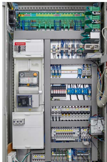
Blick in den Schaltschrank: zentrale Steuerung mit Kommunikationsmodulen
